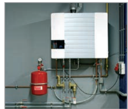
Individuele lucht- en vuilafscheider in een woonhuisinstallatie
