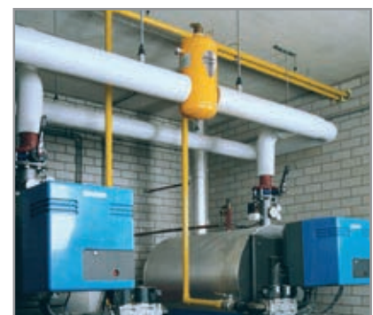
Utiliteitsinstallatie voorzien van een luchtafscheider
